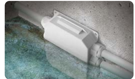
Installazione con tubi passacavo.
