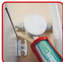
Collegamenti in Ambienti umidi
