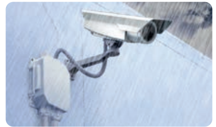
Installation avec câbles libres.
